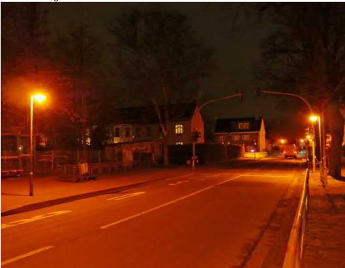
Nachtbild Schiefbahner Straße mit Bogenleuchten
