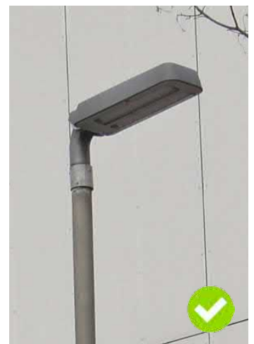
Nach oben hin abgeschirmte Mastleuchte in LED-Technik
